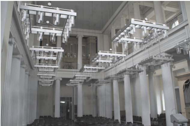
Herabfahren der Beleuchtungsanlagen zu Wartungszwecken
